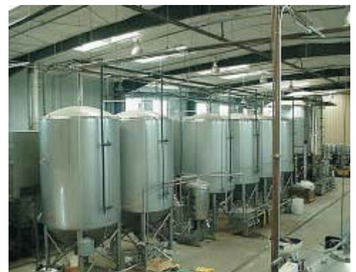
Serbatoi di immagazzinamento Disinfezione dei serbatoi con Catholyte e ANK
