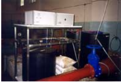
Vista generale del sistema di Disinfezione dell'acqua Enviolyte
