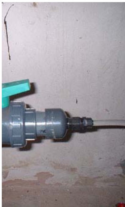
Punto di dosaggio dell'Anolyte
