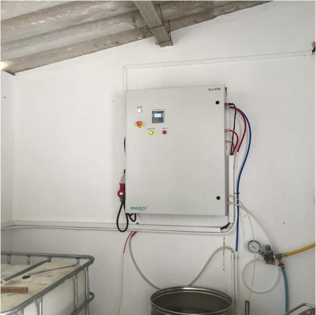
Generatore di Anolyte ELA-4000 installato presso il centro di produzione dell'azienda in 7960-189 Vidigueira, Portugal. Cortes de Cima ha un altro generatore di anolyte – ELA-2000 – installato presso la costa, dove la società ha i propri vigneti.
